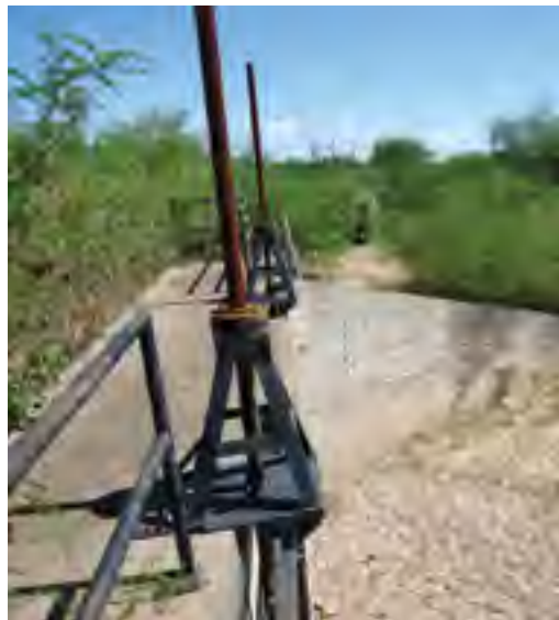
COMPUERTA Y DEFENSAS DEL RÍO BERMEJO, CERCA DE VILLA RÍO BERMEJITO.
