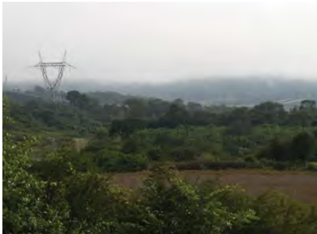
TENDIDO DE ALTA TENSIÓN A LA VERA DE LA RUTA 34 EN EL CHACO SERRANO, METÁN, PROVINCIA DE SALTA.
